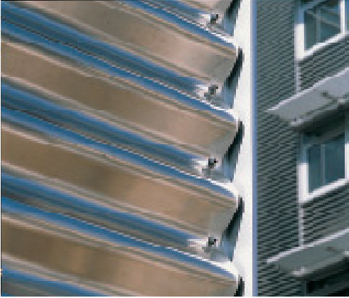
Rostfria profilplåtar med synliga regelbundet insatta rostfria fästskruvar.
