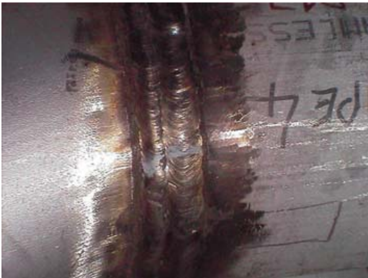
Spawana część ze stali nierdzewnej bez dodatkowej obróbki, polegającej na usunięciu zgorzeliny tlenkowej, może prowadzić do korozji.
