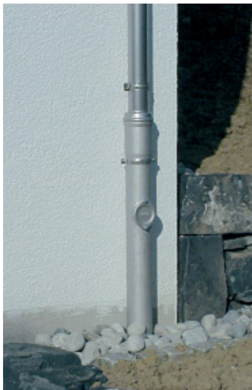
Pluviale con sportello d'ispezione.
