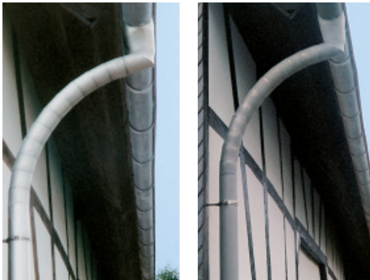
Utvecklingen av patina på förtennad rostfri plåt av typ 1.4404. Till vänster: Nytt; Till höger: Efter cirka två års exponering
