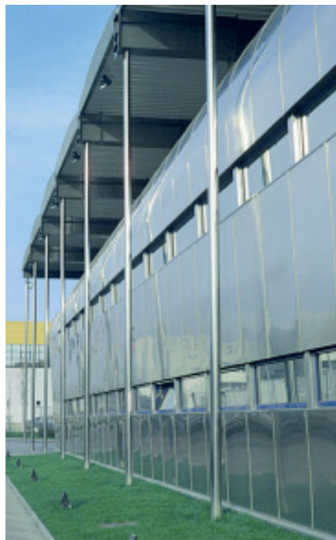
Stuprör av blankglödgat rostfritt stål vid ett service-center för stål i Gavà, Spanien.
