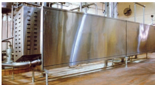
Tento výměník tepla je vyroben z duplexní korozivzdorné oceli a používá se pro vaření rajčatové a sojové omáčky nebo omáčky pro opékání masa. Fotografie: Dimpleflo
