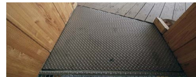
Piso de aço inoxidável no centro de visitantes, Koblenz, Alemanha. Foto: Euro Inox, Bruxelas, Bélgica
