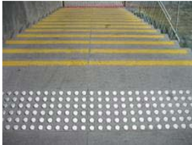
Sistemas de orientação de piso tátil em aço inoxidável são duráveis e atraentes. Fotos: Euro Inox, Bruxelas, Bélgica
