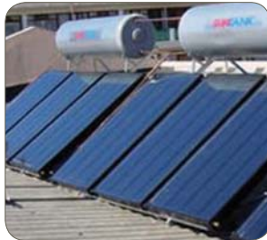
EN 1.4509/441 (실린더), Sun tank and SASSDA, 남아프리카공화국
