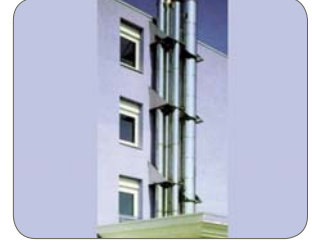
연통기 (CHIMNEY DUCT)
