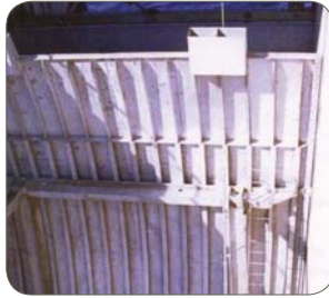
홍수 방지 수문 (FLOOD CONTROL GATES)
