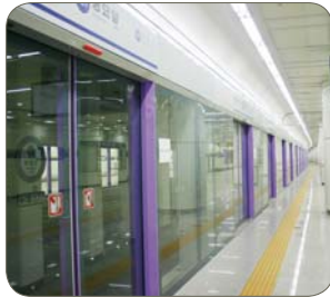
스크린도어 (PLATFORM SCREEN DOOR)
