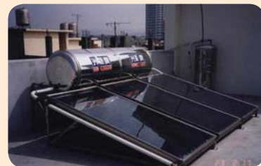
Aquecimento solar para água, Taiwan, China
