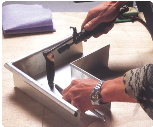
Solda branca em uma calha de aço inoxidável 430 Ti, revestido de estanho.
