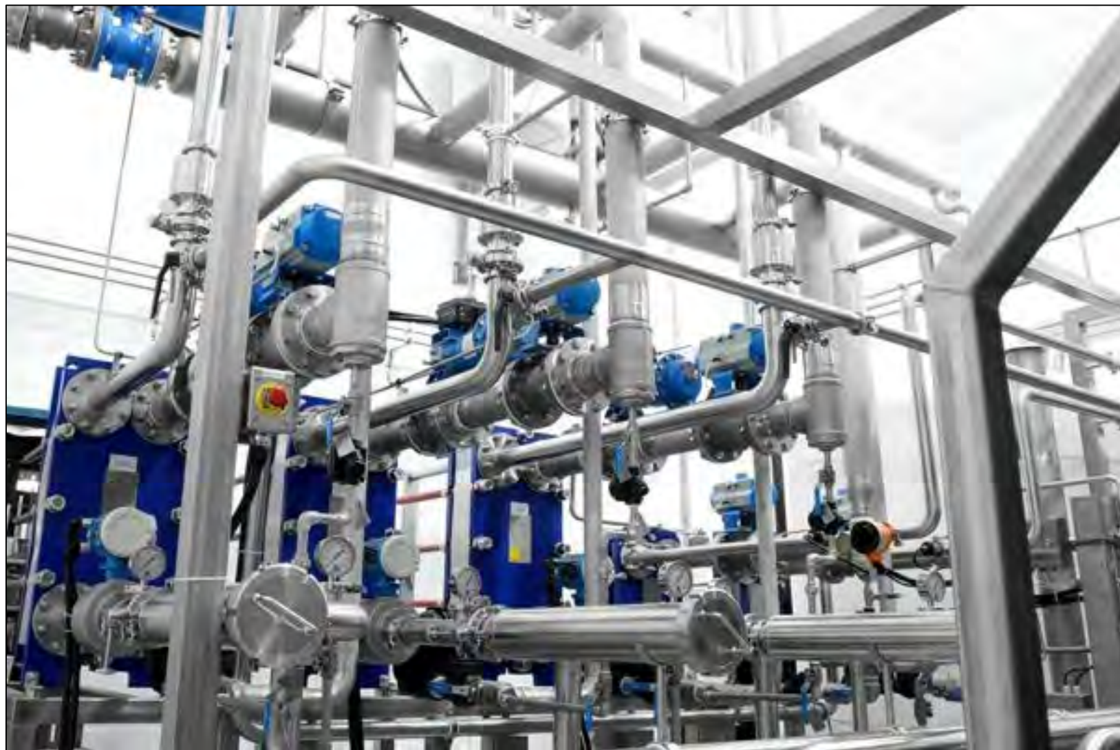
不锈钢管道系统
