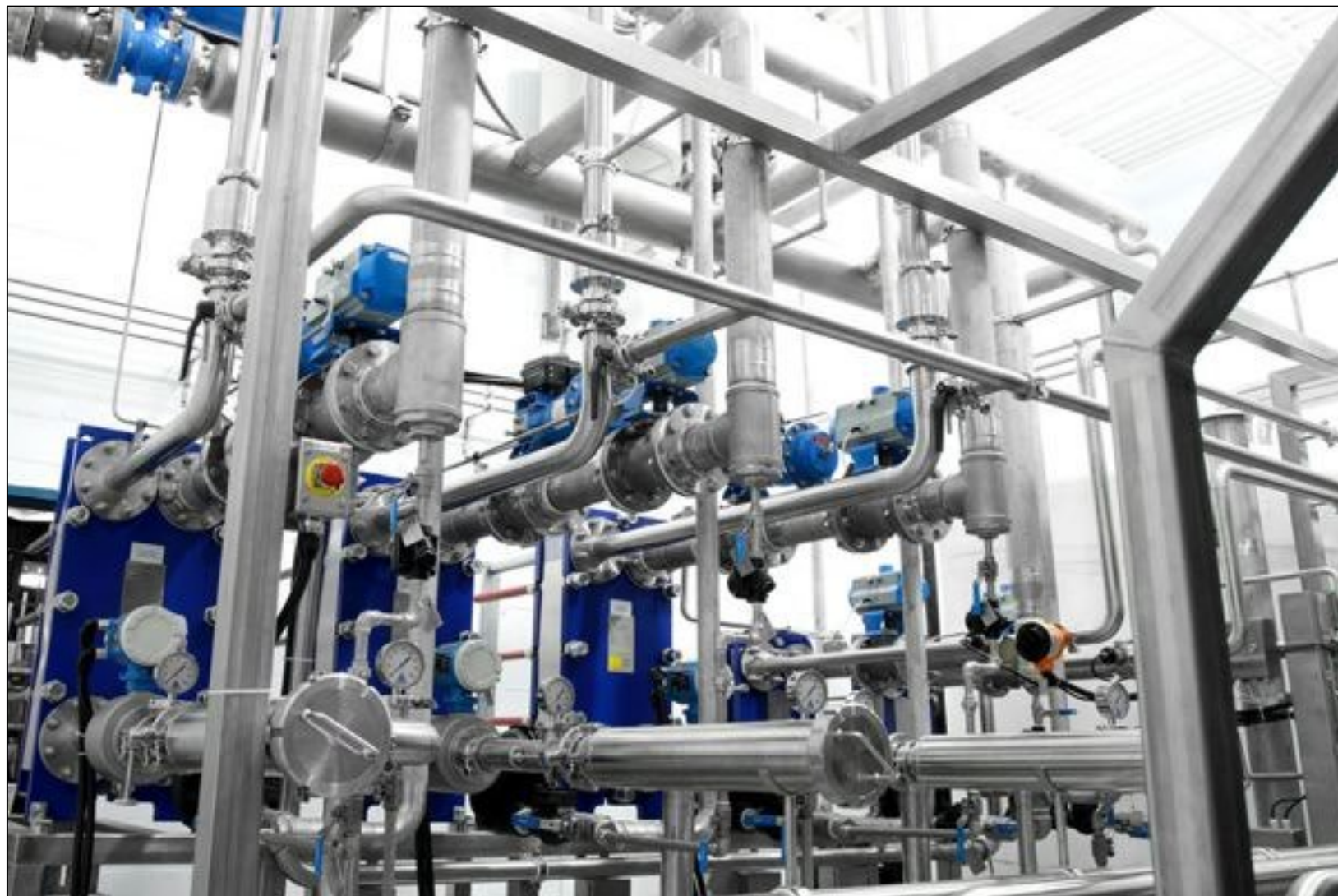
不锈钢管道系统
