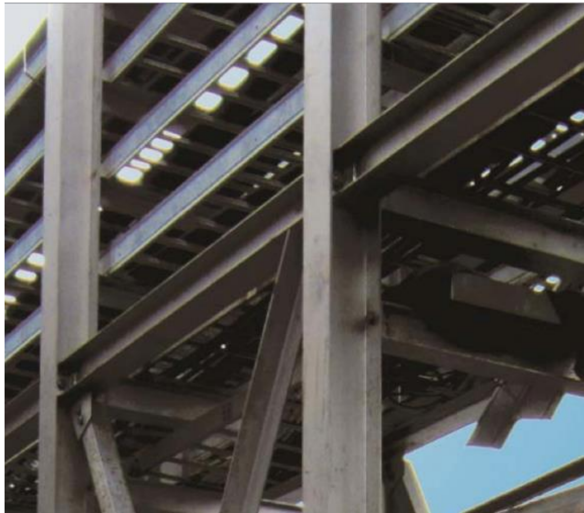
Fotografia: Elementi strutturali in acciaio inossidabile LCC
