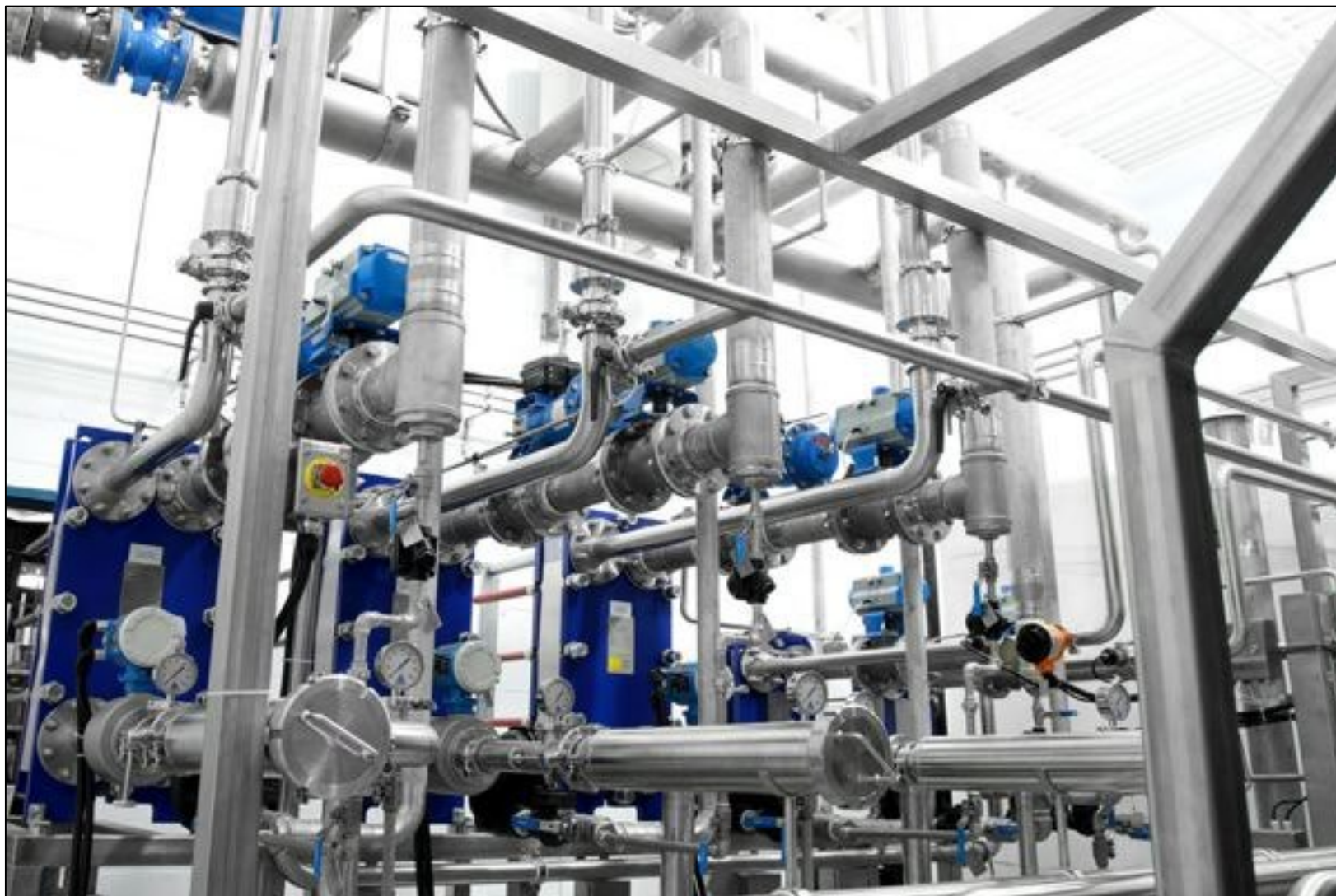
Instalacja rurowa ze stali nierdzewnej
