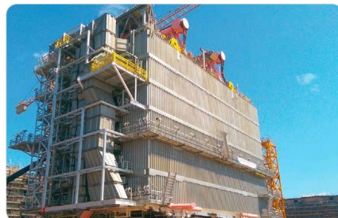
防爆墙 供图：机械工具工程公司
