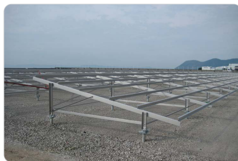
双相不锈钢SUS821L1制作的太阳能电池板支架 供图：日本制铁不锈钢株式会社
