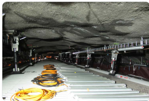
霍尔默斯特兰地铁隧道的动态吊架 供图：桑德维克材料技术公司
